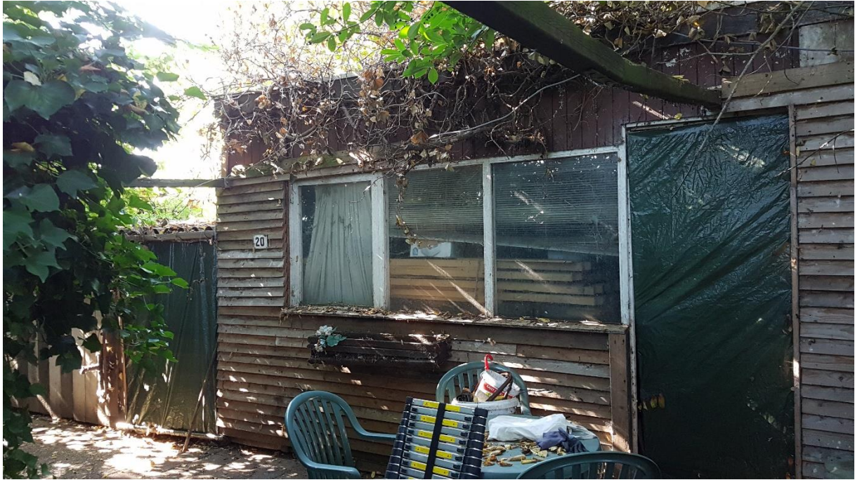
Foto 14: het middelste schuurtje waarin vleermuis fecaliën zijn aangetroffen. Het gepotdekslede hout is zeer geschikt voor vleermuizen.
