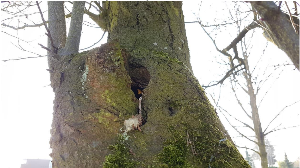
Foto 11: andere zijde van het gat met een tweede opening waardoorheen licht is te zien.
