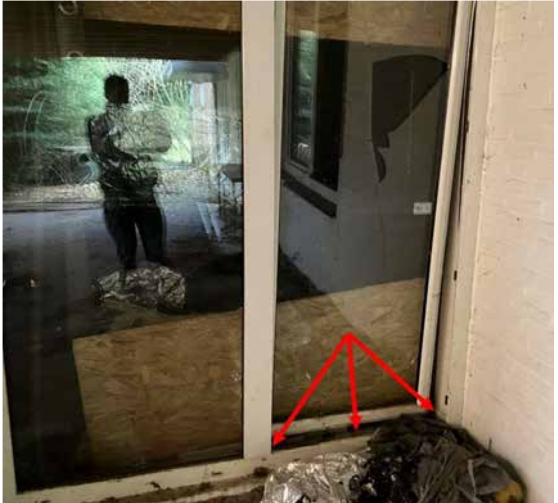
Figuur 2: Beschadigd raamkozijn/schuifpui op locatie A (zie figuur 1), waardoor steenmarter potentieel toegang krijgt tot interne delen van het Chalet. De opening is momenteel provisorisch afgedicht met ter plaatse beschikbare materialen. Dient z.sm. deugdelijk te worden afgedicht, bijv. door het bevestigen van een plaat over de volle hoogte en breedte van de kozijn.
