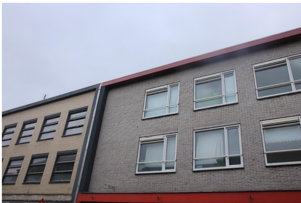
Foto 1: Het dak en het gebouw is geheel ongeschikt voor broedvogels (al of niet met jaarrond beschermde nesten) om als nestlocatie te dienen
