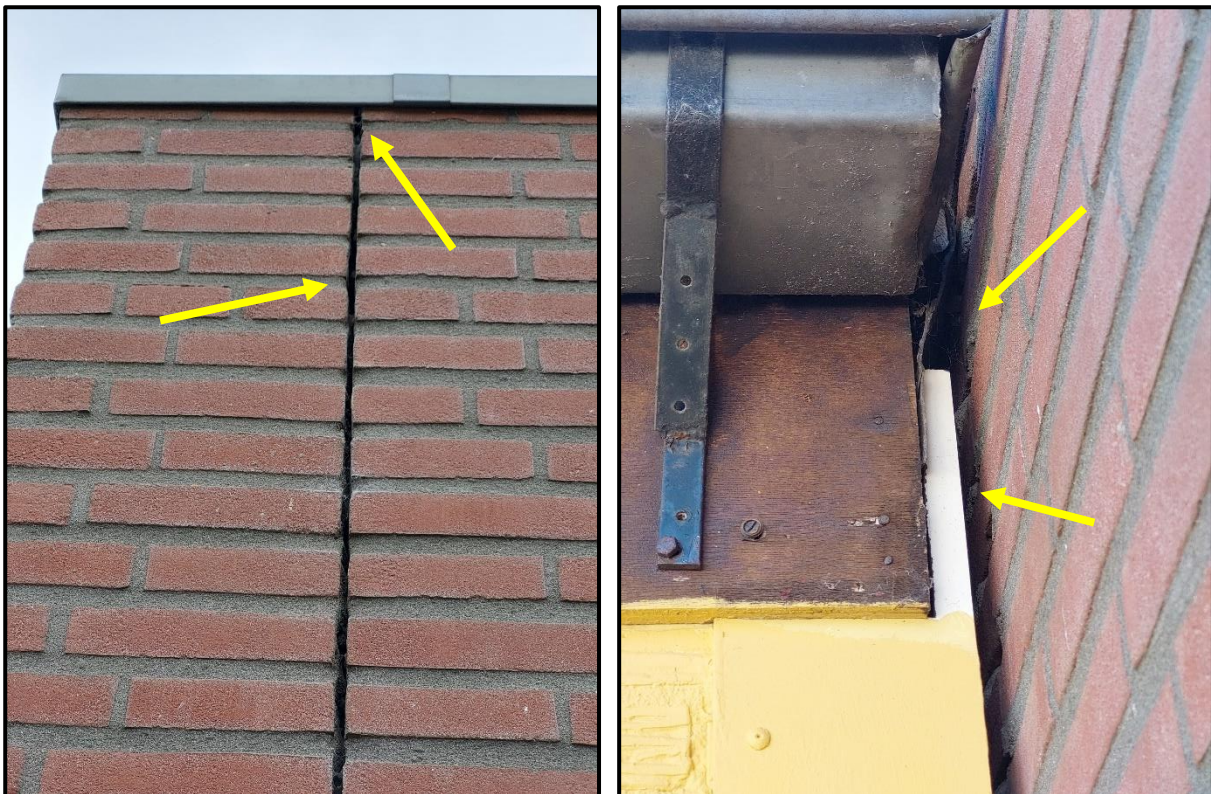
Figuur 4.2 Weergave van de potentiële verblijfplaatsen van vleermuizen in de dilatatievoeg en tussen de dakgoot en de muur bij de gele pijlen.
